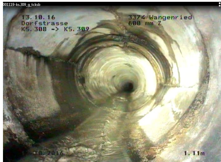
Abbildung 1: Kanalfernsehaufnahmen 2016, grober Schaden bei KS 308 in Richtung KS 309
