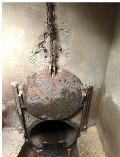
Abbildung 2: Rinnenschütz im Kontrollschacht 309
